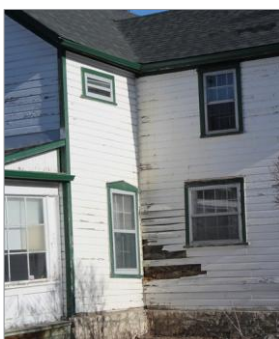
Maison Bleak, 1637, rue Main, revêtement en bois d'origine détérioré, 2025
