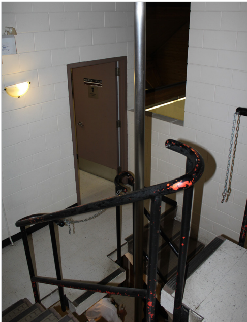
Poste d'incendie n° 4, 1083, promenade Autumnwood, escaliers et perche de pompiers, 2021
