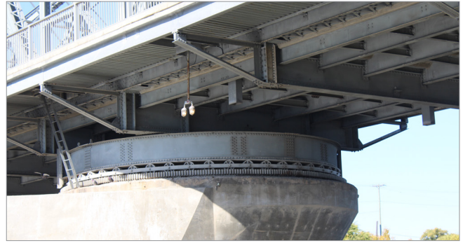
Pont Redwood, machinerie de travée pivotante, 2022
