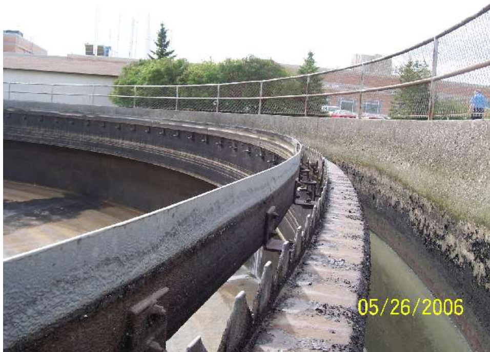
Photo 3-6 Effluent Weir & Launder
